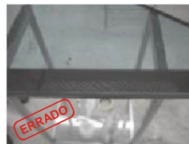
Local da fixação do suporte do vidro da porta.
