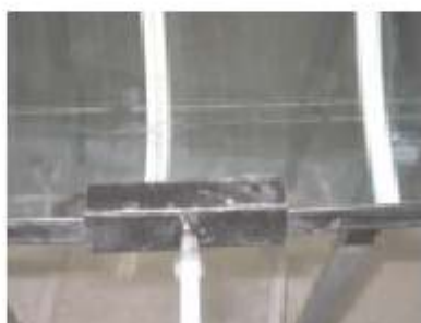
Trinca no PC
