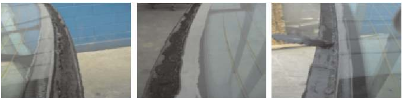
Ataque químico ao policarbonato (causado pela massa de vedação) causando delaminação e trinca do policarbonato
